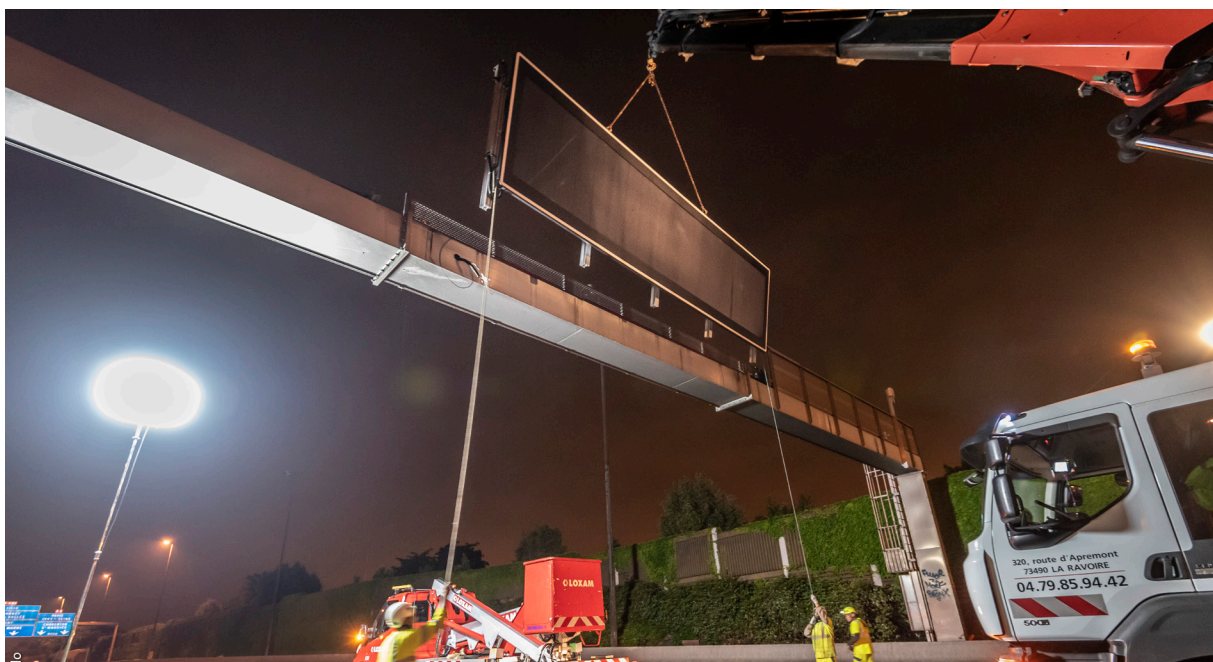
Modernisation des panneaux à messages variables (PMV) : les nouveaux équipements sont plus lisibles et peuvent afficher plus d'informations.
